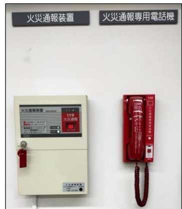
火災通報装置
