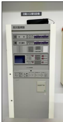
自動火災報知設備 (R型)
